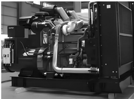
图 5 轨道交通不间断电源设备
